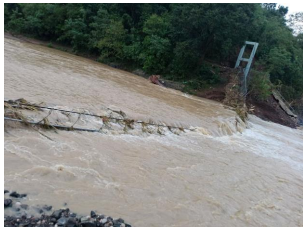
台風により流された橋
